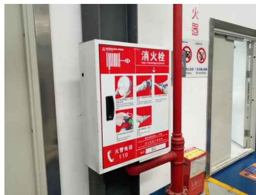
图 3-8 生产车间门口设置消防栓
