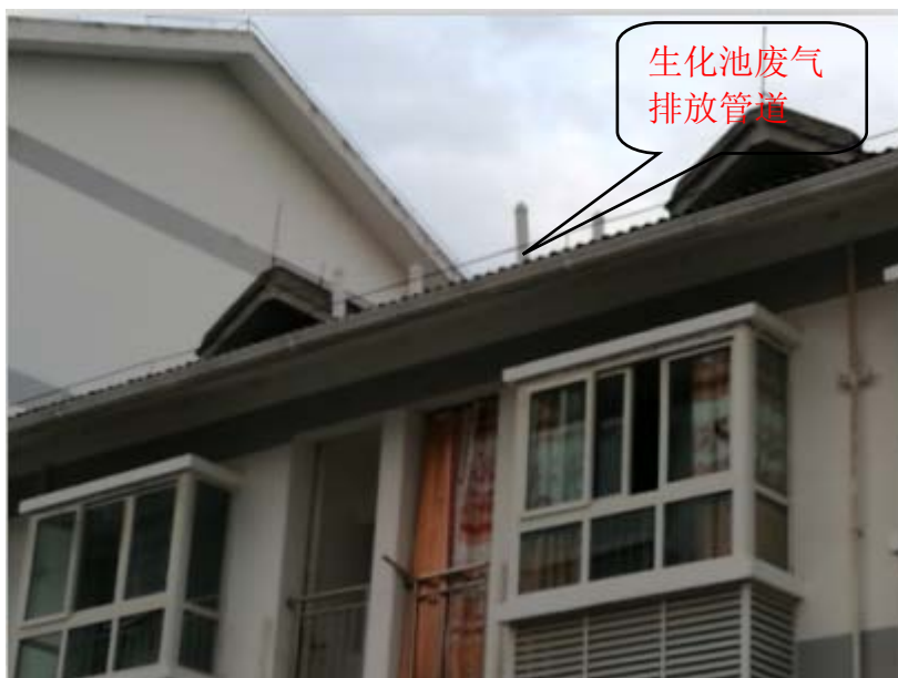
图 4-9 B 区生化池废气排气管道
