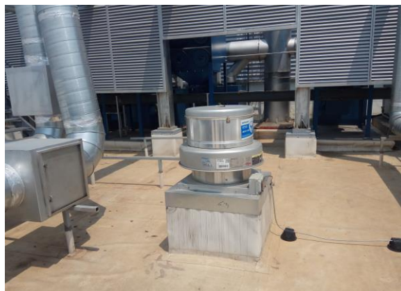
屋顶离心排风机
