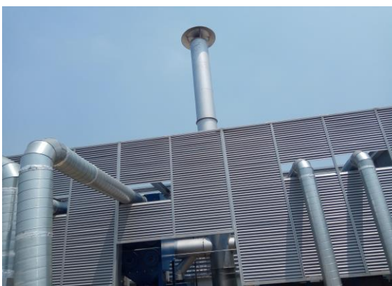
15m 高排气筒
