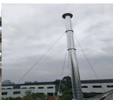
图 3-4 排气筒现场照片
