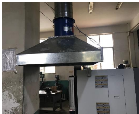
图 3-2 集气罩现场照片
