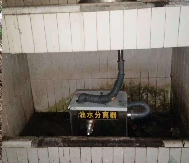
图 3-6 油水分离器现场照片
