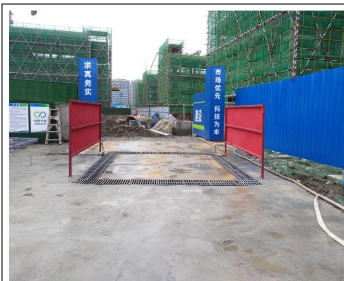
项目大门外洗车设备
